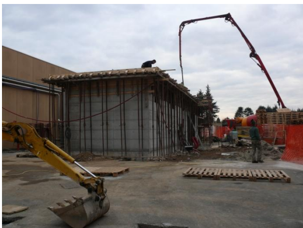
TECNIPLAST SPA – Buguggiate (VA) Centrale elettrica di trasformazione in media tensione
